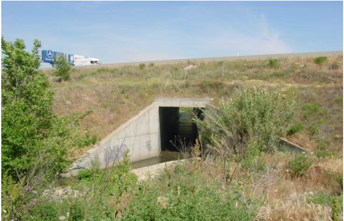
FOTO 23. O.D. formada por marco prefabricado de sección rectangular de 4,00 x 5,00 m, situada bajo la autovía A-1.
