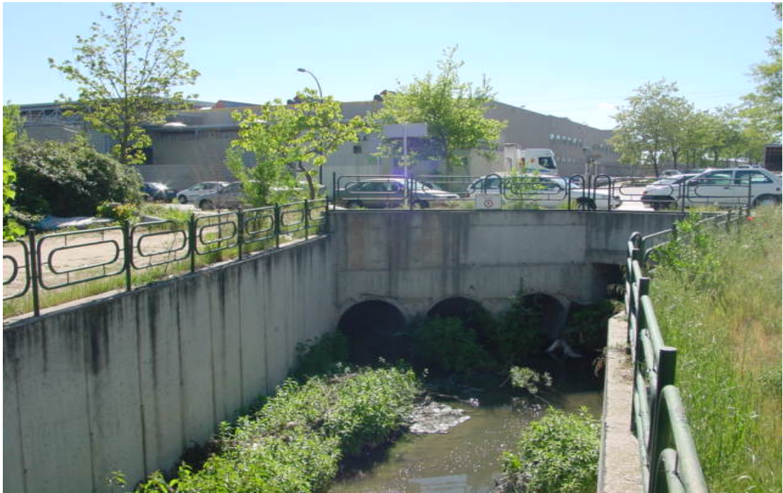
FOTO 4. Sección natural descubierta del arroyo de la Vega aguas abajo de entubamiento particular del cauce para establecimiento de nave industrial (se observa al fondo de la fotografía).
