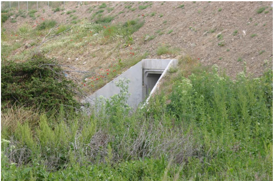
FOTO 5. Vista aguas abajo del arroyo Mesones y detalle salida obra de desagüe de la autopista R-2 formado por marco prefabricado de 2,00*3,00 m. y aletas laterales.
