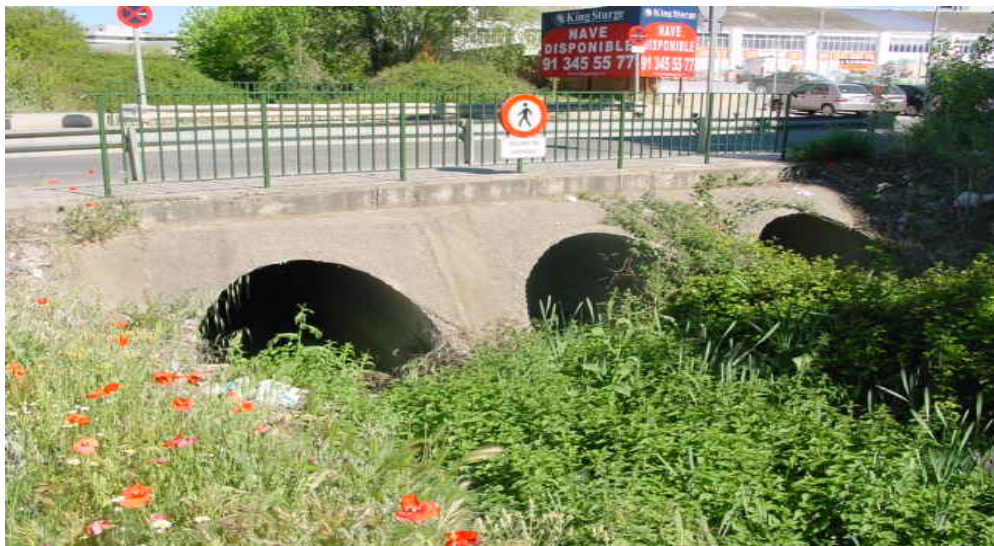
FOTO 9. Obra de paso de la C/ Francisco Gervás. El cruce del arroyo de la Vega se realiza mediante tres tubos en batería de acero corrugado tipo Arco de 2.000 mm de diámetro, protegido y rodeado de hormigón como se observa en fotografía. La corriente de agua discurre por el tubo central, con un calado de la lámina comprendida entre 30 a 40 cm., mientras que los tubos de ambos extremos se encuentran obstruidos hasta la mitad de su sección por la acumulación de gran cantidad de basuras. El presente cauce del arroyo es uno de los puntos conflictivos de la red fluvial al presentar problemas de inundación (obsérvese el cartel claramente anunciando el peligro).
