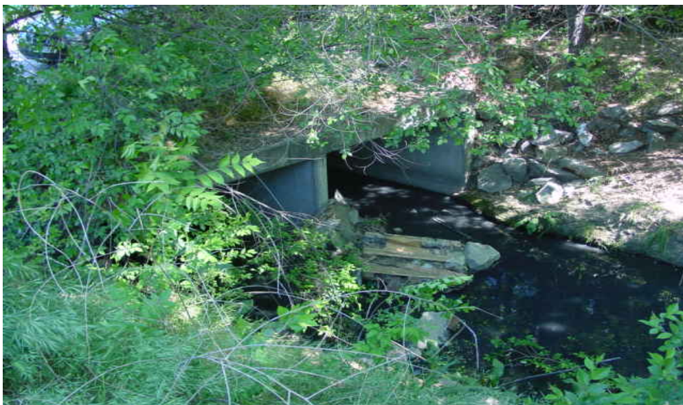
FOTO 13. Entubamiento del arroyo de la Vega, consistente en dos marcos de hormigón armado de 3,00*2,00 m. de sección libre. El arroyo en este tramo fluye con un caudal de aguas negras, con un fuerte olor a putrefacción, mientras que ambas márgenes y el cauce están cubiertos por desechos y basuras. El cauce se encuentra muy encajado con taludes verticales con una altura próxima a los 3 m.
