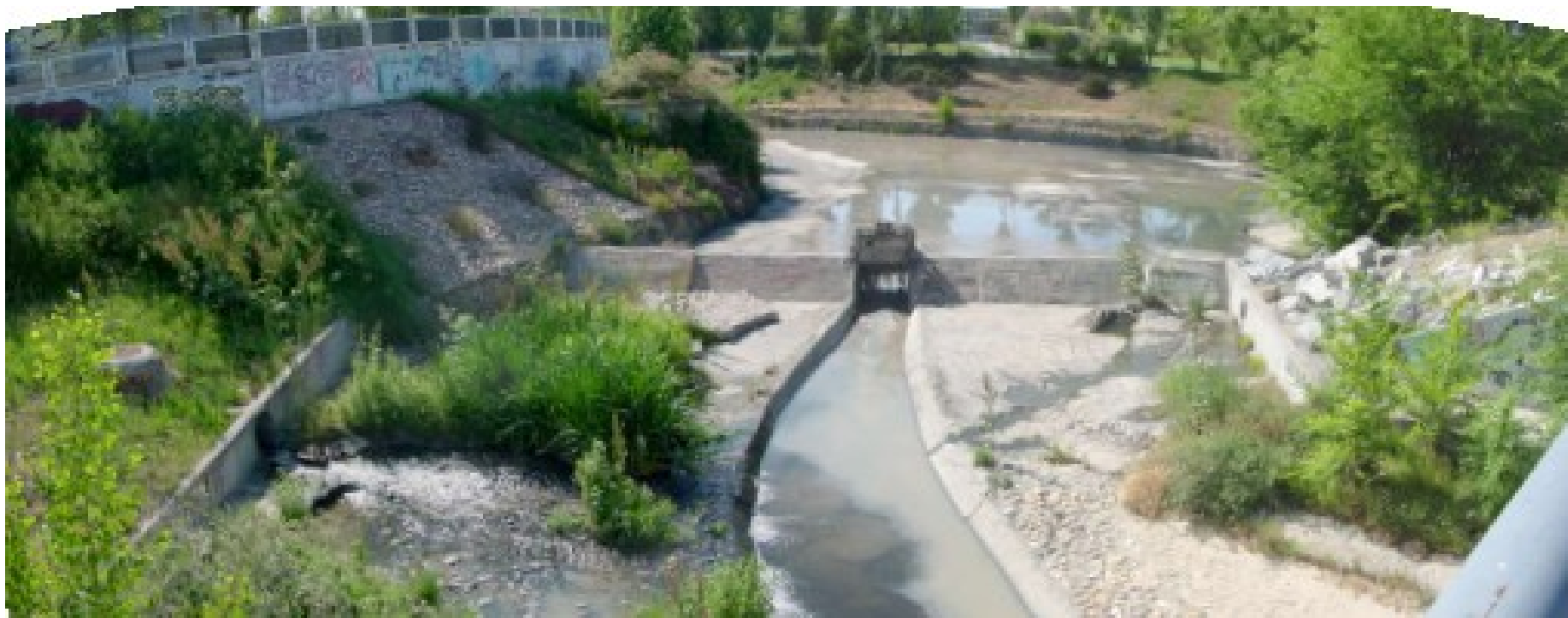
FOTO 20. Cauce del Arroyo de la Vega canalizado, aguas arriba del embalse regulador. Se observa el color que demuestra la gran contaminación del caudal circulante.
