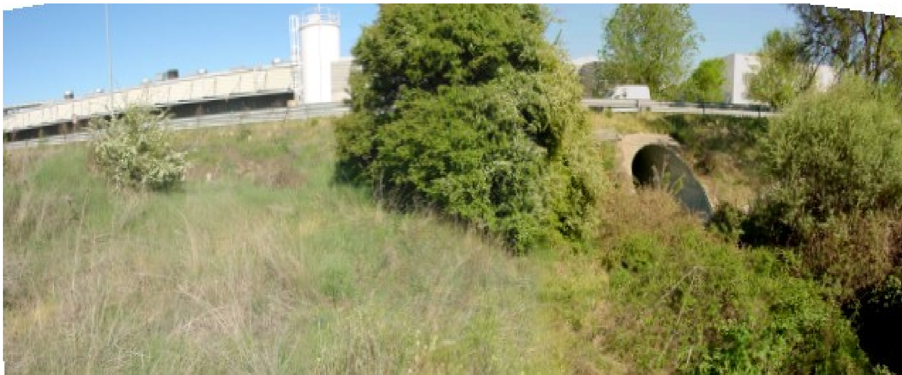
FOTO 3. Vista de fábrica en la margen izquierda y tubo tipo ARCO Multiplaca circular de 3,30 m. de diámetro en la margen derecha, presentando la lámina de agua un calado de 15 cm. Se observa gran cantidad de vegetación que cubre el cauce.
