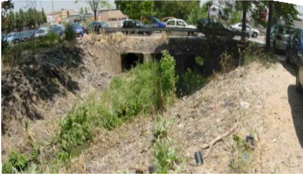
FOTO 8. Vista general de la O.D. sobre el cauce del Arroyo de la Vega bajo la C/ Valportillo, hacia aguas abajo. Consta de tres tubos tipo ARCO de 2,00 m de diámetro. El caudal pasa sólo por el tubo central. Gran cantidad de basura y maleza obstaculizando el cauce.
