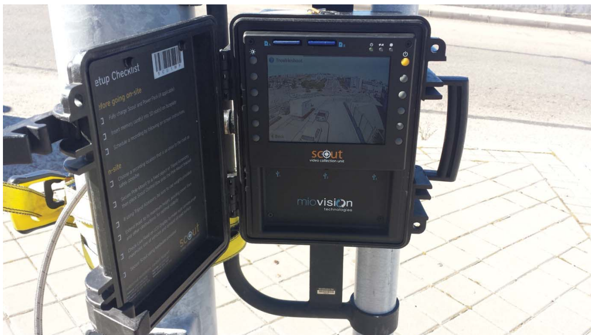
Imagen 13. Detalle 1 de cámara de visión artificial glorieta Avda. de Valdelaparra/Avda. del Dr. Severo Ochoa.
