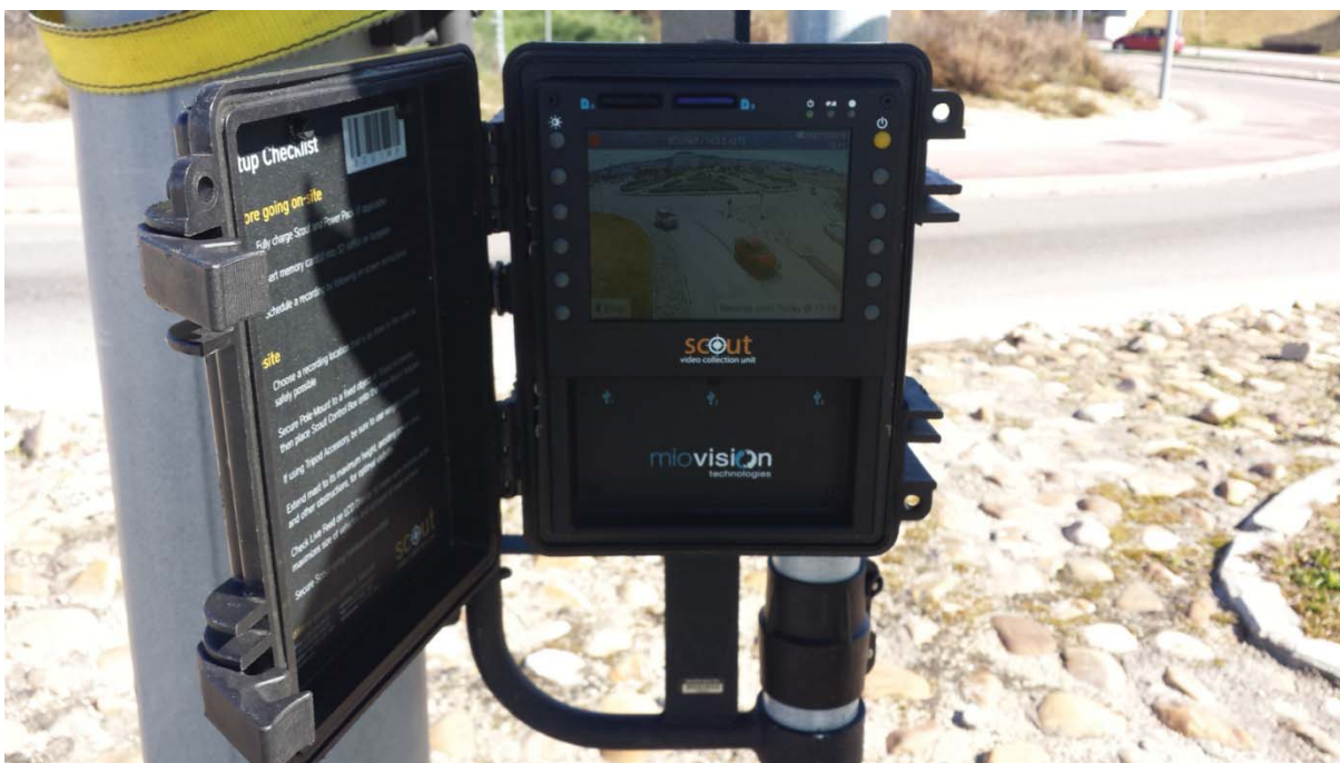
Imagen 10. Detalle 2 de cámara de visión artificial en glorieta M-616/Avda. de Valdelaparra.
