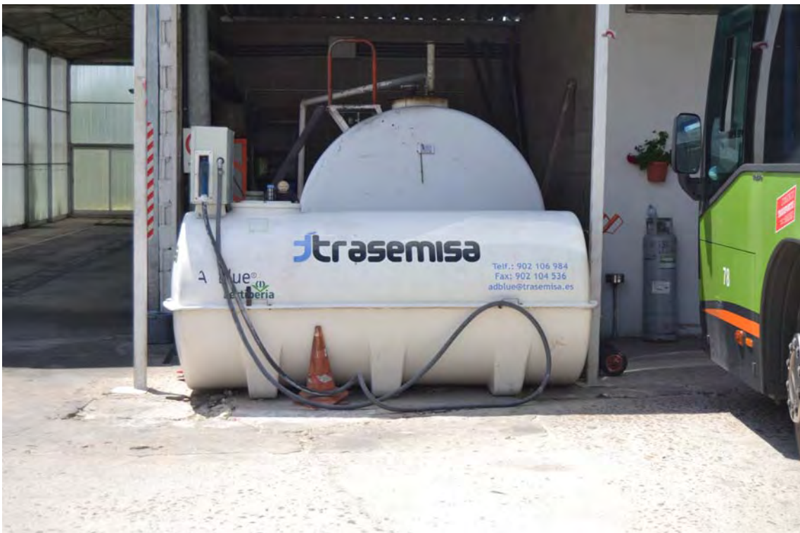
Fotografía 2. Detalle del depósito de combustible y de aditivo.
