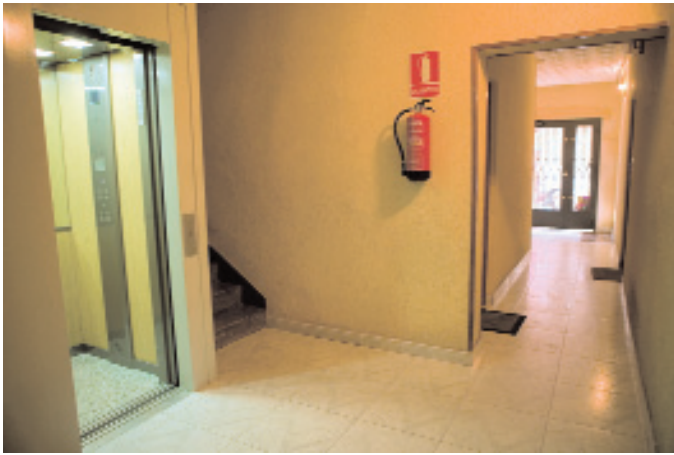
Ascensor instalado en la comunidad de vecinos de la calle Dos de Mayo, 12.
