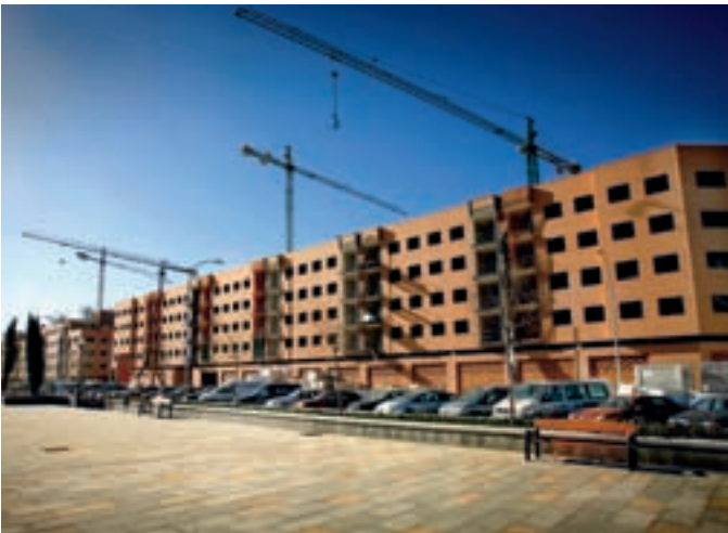
La viviendas de Fuente Lucha se encuentran en estado avanzado
