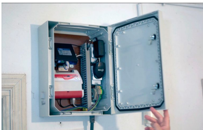
Imagen del cajetín donde se controla el sistema de telegestión del riego.
