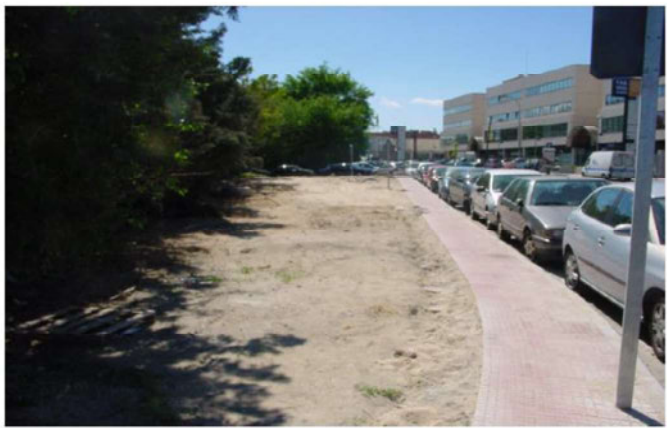
FOTO 14: Tramo del arroyo de la Vega entubado recientemente, junto a la Avda de la Industria.
